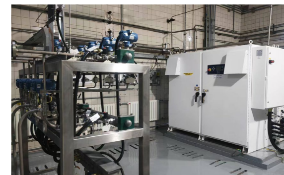
PEM 制氫系統現場照片
